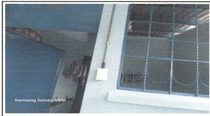
Foto 4: se puede apreciar la reparación del cableado electrico y como quedo bien ordenado y debidamente cubierto para evitar accidentes con los estudiantes.
