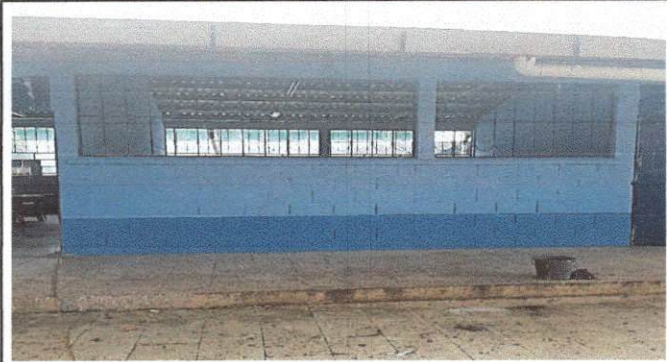
Foto 9: El trabajo de pintura en las paredes del establecimiento a concluido podemos apreciar como quedo la presentación de las aulas.
